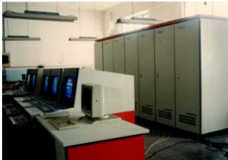
图 3 重庆自动化仪表所的 CAMS3000 现场总线控制系统
